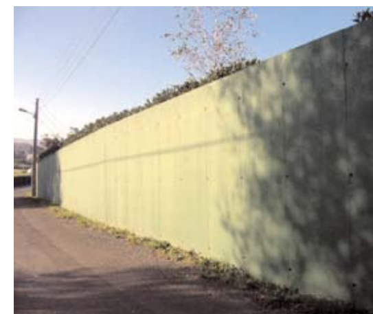
Muro da vivenda de José Maria Campo que incumpe a ordenaçom municipal. Foi definido polo arquitecto municipal como 'tradicional' para nom ter que derrubá-lo
